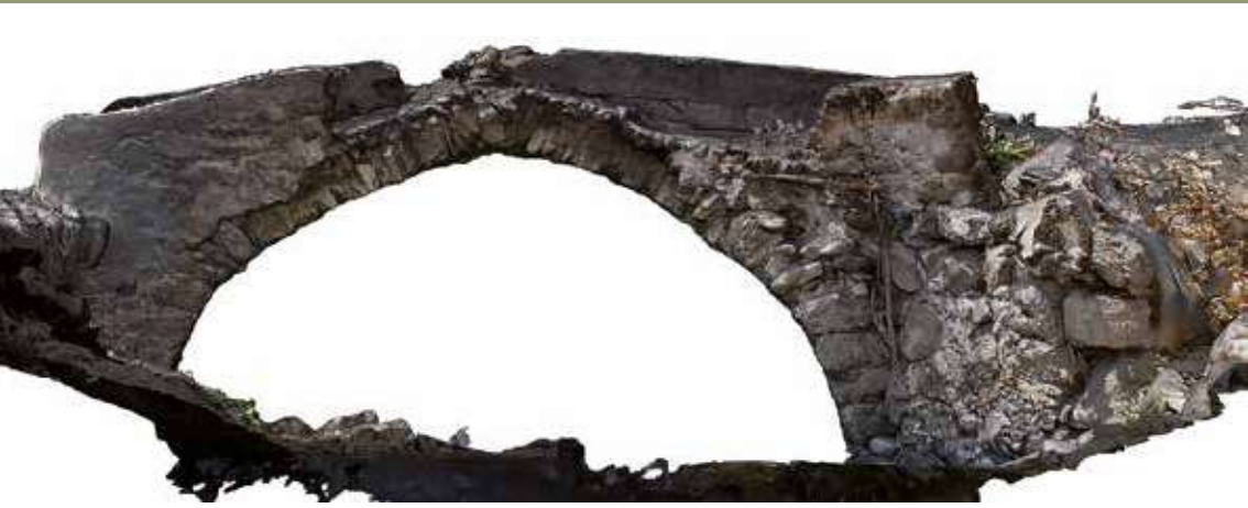
Fig. 50. Ponte don Jaime Tresnuraghes-Sennariolo di Rio Mannu prima dell'incendio.
